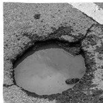
Potholes Baches الحفر
